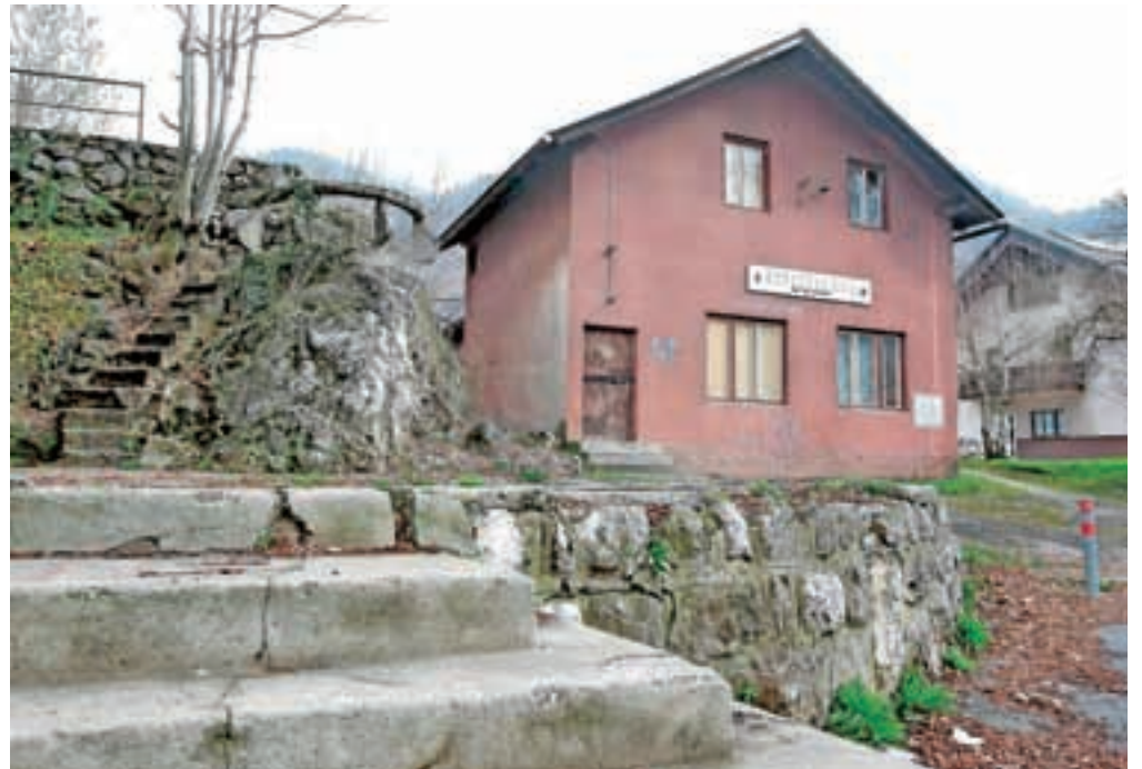
Dotrajano stavbo Šahovskega doma je za dobrih 20 tisoč evrov kupil zasebnik in jo bo podrł, kaj bo zgradil na njenem mestu, pa še ni želel razkriti. / Foto: Gorazd Kavčič
