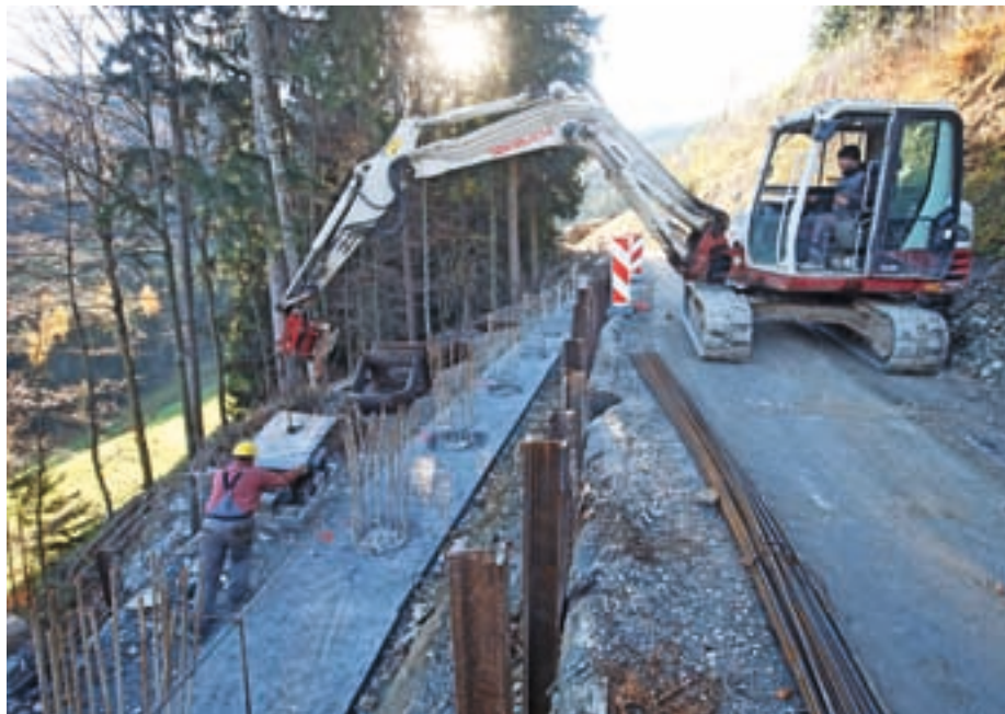
V proračunu za prihodnje leto je tudi denar za dokončanje sanacije zemeljskega plazu pod lokalno cesto nad Mšičem v Martinj Vrh. / Foto: Gorazd Kavčič
