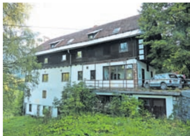
Hotel Belcijan v Planini pod Golico že vrsto let žalostno propada, tudi najnovejši poskus oživitve očitno ni uspel.
