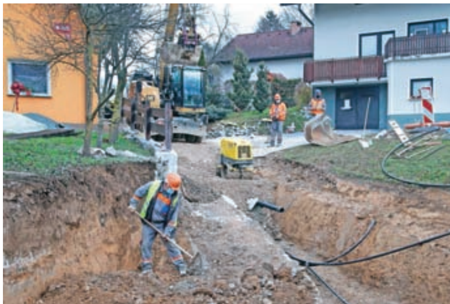
Projekt Gorki 2 na Mlaki (gradnja kanalizacije, vodovoda in razsvetljave) se počasi zaključuje.
