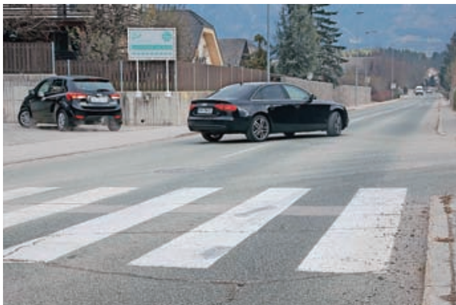
Med izvajanjem projekta Gorki so na glavni prometnici skozi Mlako nastale vidne poškodbe.
