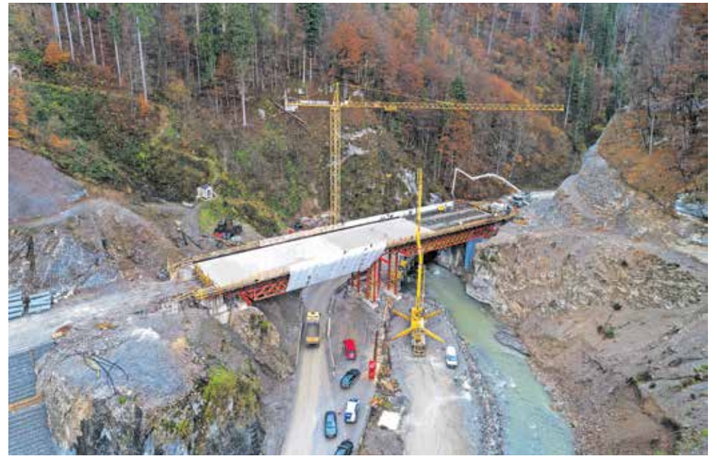
Sedemdeset metrov dolg most, ki so ga nedavno zabetonirali, bo potekal čez dvajset metrov visoko zemeljsko pregrado, ki bo zadrževala visoke vode. / FOTO: ARHIV OBČINE ŽELEZNIKI/ANDREJ TARFILA
