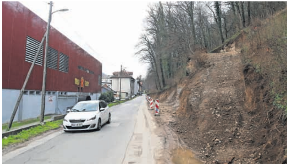
Poleg izgradnje opornega zidu bodo Savsko cesto na tem delu tudi razširili. / FOTO: GORAZD KAVČIČ
