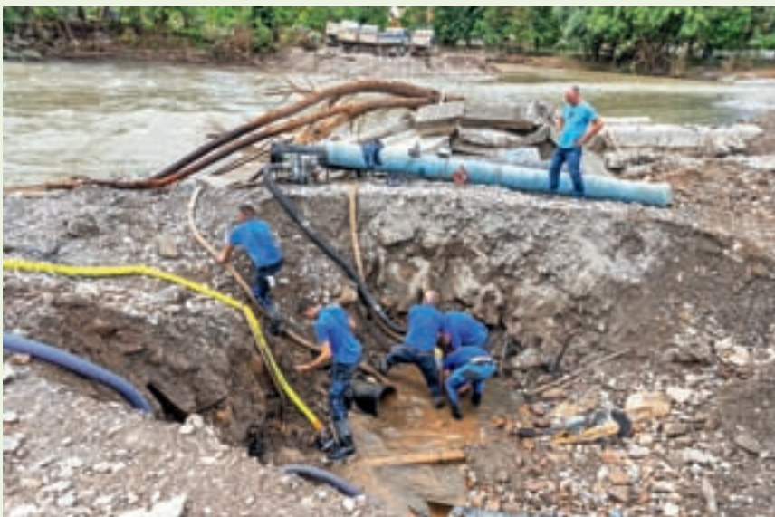
Poplave so poškodovala ogromno cevi javne kanalizacije. / Foto: Andrej Tarfila
