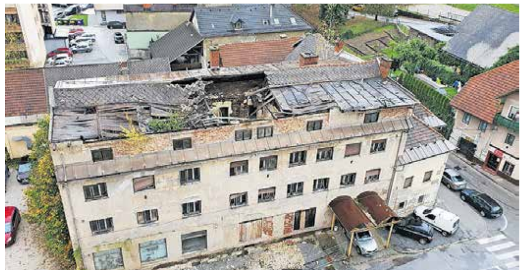
Propadajoča stavba nekdanjega Hotela Pošta sredi Jesenic / Foto: jeseniška občanka
