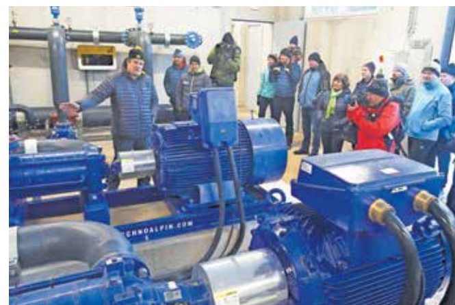
V sklopu zasneževalnega sistema so na Soriški planini uredili tudi sodobno črpališče za vodo. / FOTO: GORAZD KAVČIČ
