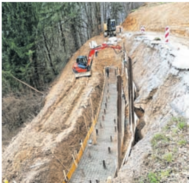
Na cesti proti Hlavčim Njivam poteka sanacija več plazov in manjših usadov. / FOTO: ARHIV OBČINE
