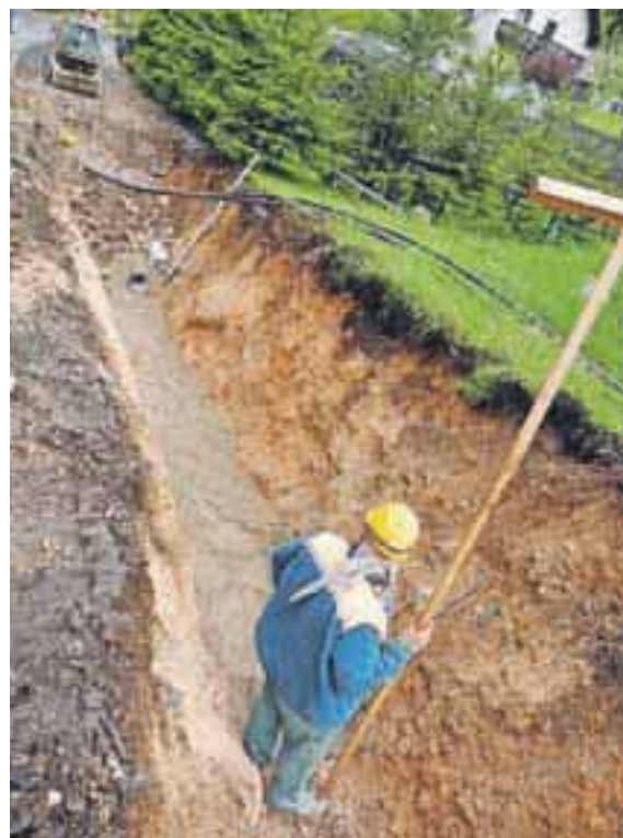
Izvedba javnega voda kanalizacijskega omrežja za naselje Zgornje Jezersko ob regionalni cesti
