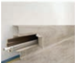
Veliko prostora za napeljavo kablov
