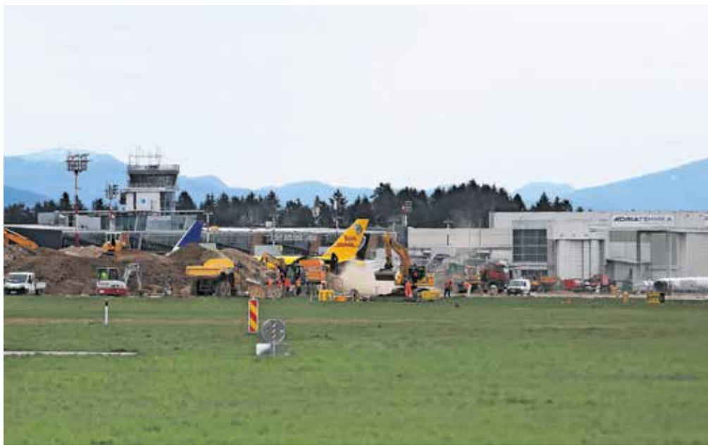
Kot so pojasnili v Fraportu Slovenija, je na obstoječi voznici stezi A trenutno v teku izvedba novih kabelskih kanalizacij, na območju nove vozne steze J pa utrjevanje terena, gradnja novih ponikovalnic in kabelskih kanalizacij. / Foto: Gorazd Kavčič
