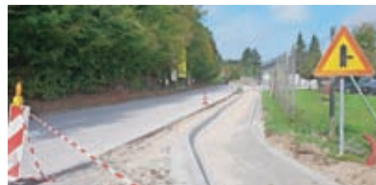
Posnetek je z obnove dela pločnika na odseku od Podrebra do Kmetijske zadruge. Vgrajen je tudi plinovod in postavljena javna cestna razsvetljava. / Foto: Ivan Meglič
