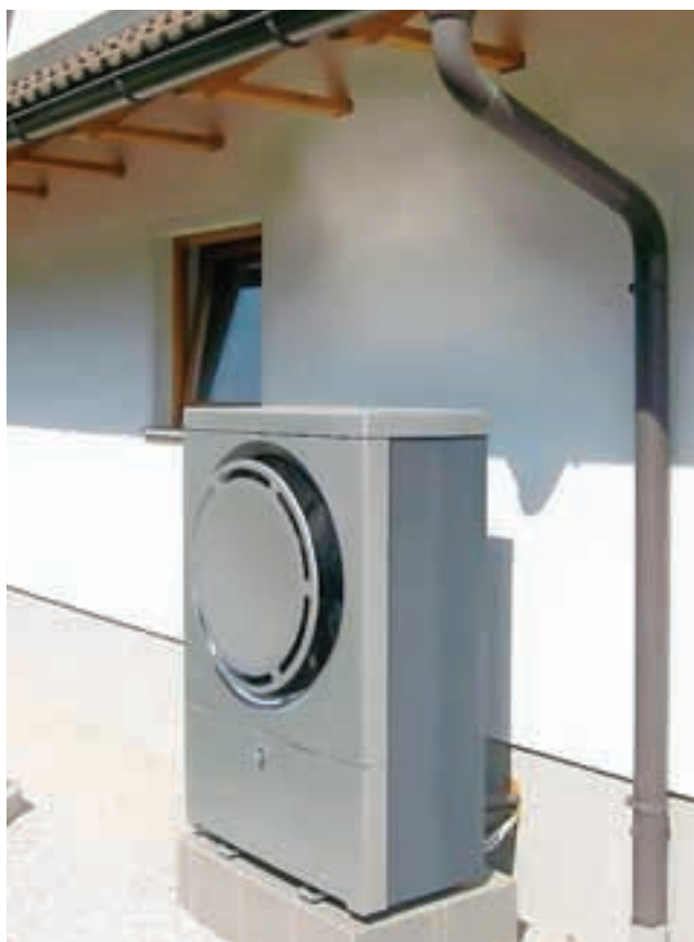
Zunanja enota toplotne črpalke Thermia Atec 13
