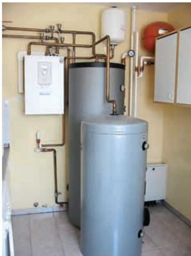
Notranja oprema toplotne črpalke
