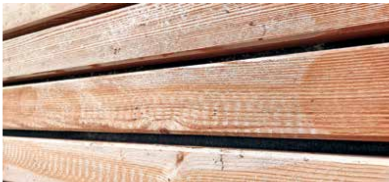
Poškodbe na lesu – pogosta napaka pri čiščenju z visokotlačnim čistilnikom
