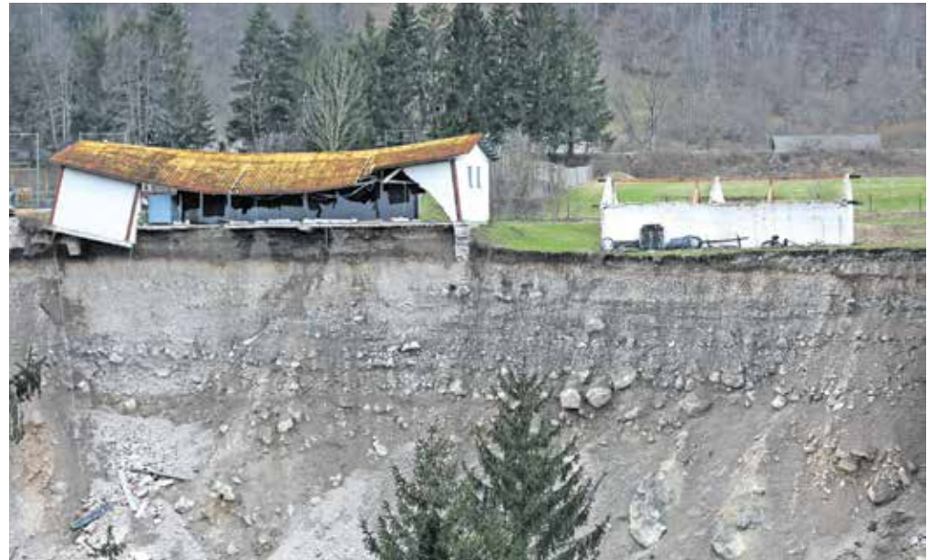
Izvajalec je do zdaj odstranil vse notranje regale v skladišču, kritino na manjšem objektu in polovico kritine na večjem objektu. / Foto: Gorazd Kavčič
