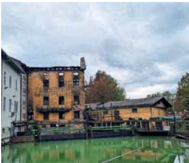
Zaradi požara ne more več obratovati hidroelektrarna Sava, ki stoji na obrobju mesta Kranj. K prvim sanacijskim delom so Gorenjske elektrarne pristopile že decembra. / FOTO: ELEKTRO GORENJSKA
