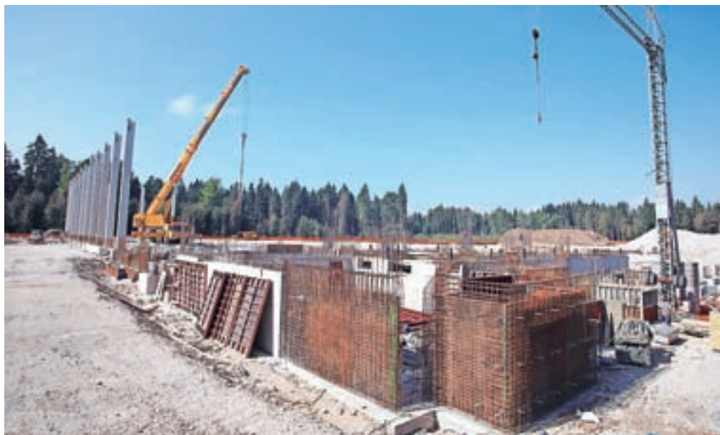
Kar petindvajset tisoč kvadratnih metrov velik logistični center ob brniškem letališču bo končan prihodnje leto. / FOTO: GORAZD KAVČIČ
