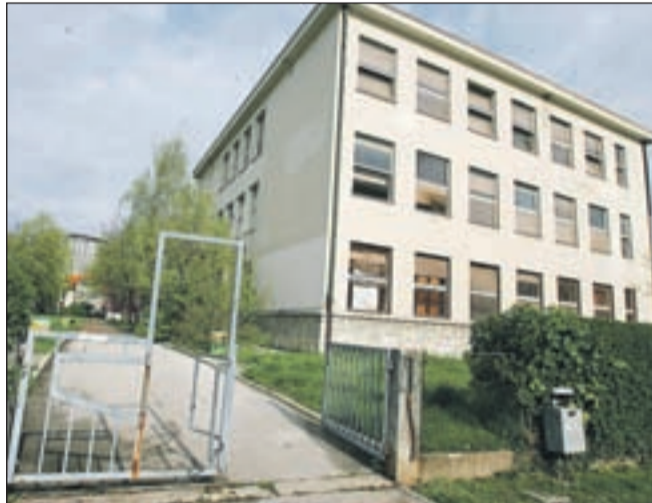
Stavba nekdanje ekonomske šole od njene selitve žalostno propada. | FOTO: TINA DOKL
