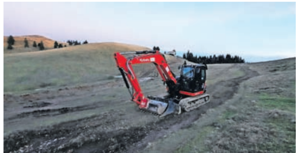
Gradbeni stroji brez oznak so bili parkirani na različnih delih gradbišča in niso imeli nameščenih posod za lovljenje olja in naftnih derivatov, trdijo v AAG. / Foto: arhiv društva Alpe Adria Green
