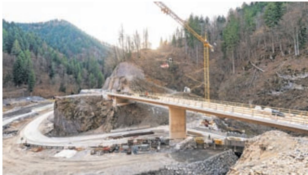
Na lokaciji pod Sušo v bližini Zalega Loga urejajo območje zadrževalnika, ki bo lahko zadržal milijon kubičnih metrov vode. / FOTO: SIMON BENEDIČIČ
