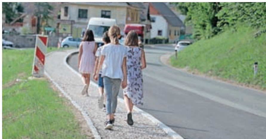
Posnetek je še iz časa gradnje komunalne in cestne infrastrukture v Podbrezjah, ki pa je že zaključena. Zagotovili so tudi varnejšo šolsko pot.
