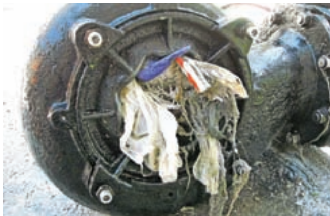
Črpalka, ki je prenehala delovati zaradi nepravilno odloženih odpadkov v fekalno kanalizacijo
